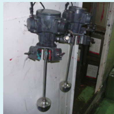
●塗料缶の中を常時、攪拌する時に使用するエアーマーターとエムレボ。
